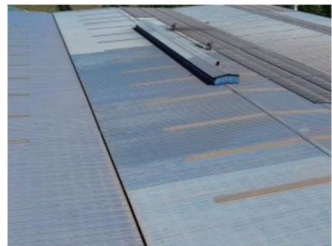
某工程5年厂房现状 出现油漆粉化脱落、基板裸露生锈
